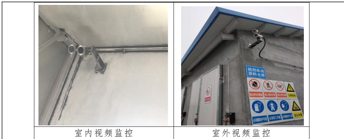
图 3-1 室内及室外监控
